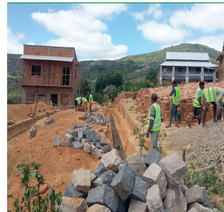
Links das kleinere der zwei Gebäude und im Vordergrund sind die Fundamente des zweiten Gebäudes zu erkennen.
